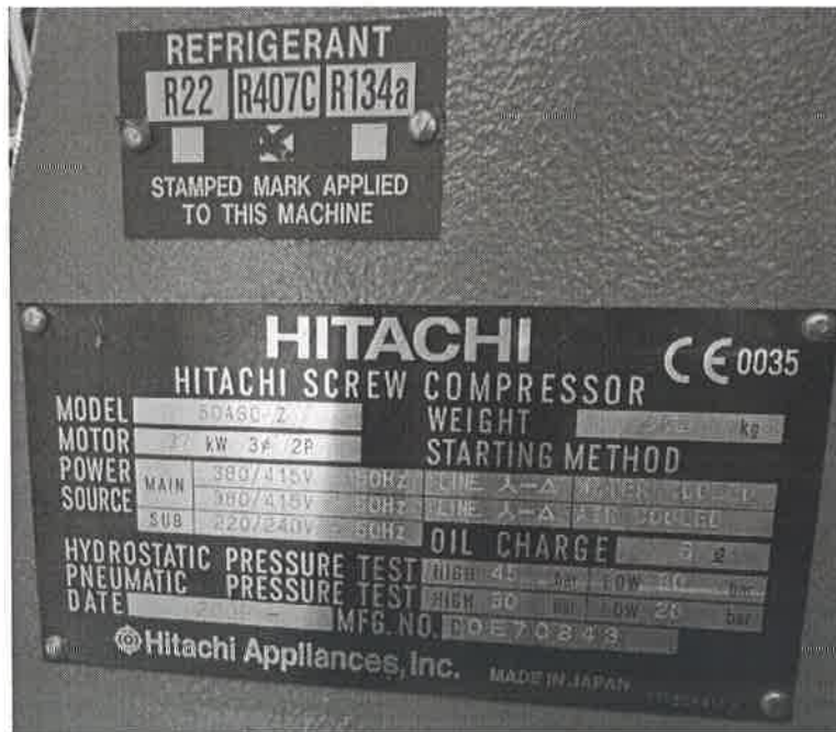
a felújítandó kompresszorok adattáblája
